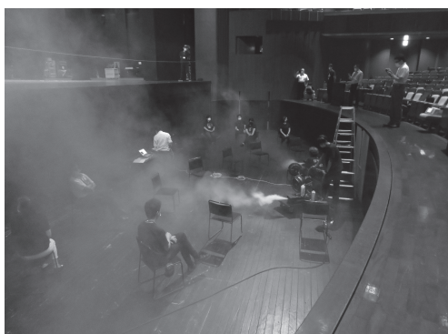
図17：コロナ禍に新国で実施した空調テスト (オーケストラピット)
